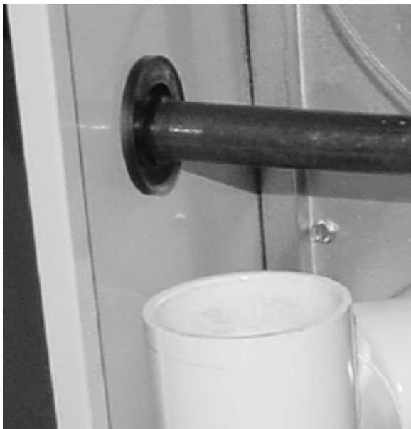
Figure 23 - Raccordement de l'approvisionnement en gaz de la fournaise (remarquer l'œillet de plastique)
