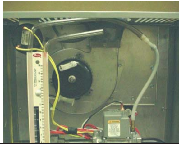
FIGURE 14 - MANOMÈTRE MESURANT LA PRES-SION DU GAZ DU COLLECTEUR
