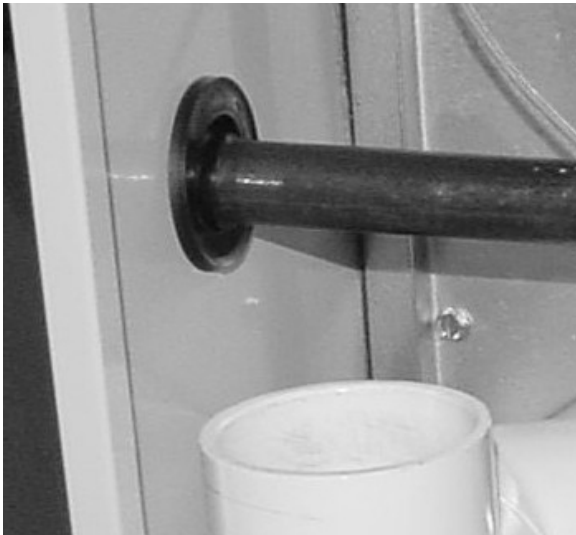
Figure 23 - Raccordement de l'approvisionnement en gaz de la fournaise (remarquer l'œillet de plastique)
