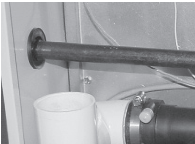
Figure 28 : Raccordement de l'approvisionnement en gaz de la fournaise (remarquer l'œillet de plastique)
