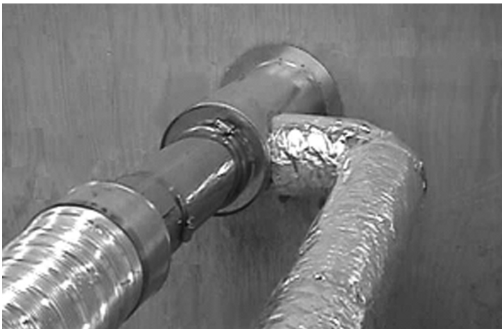
Figure 4 - Vue intérieure de la terminaison de l'évent
