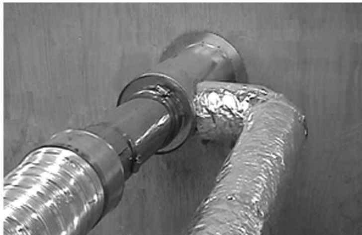
Figure 4 – Vue intérieure de l'extrémité de l'évent
