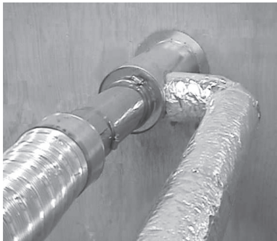
Figure 4 : Vue intérieure de l'extrémité de l'évent
